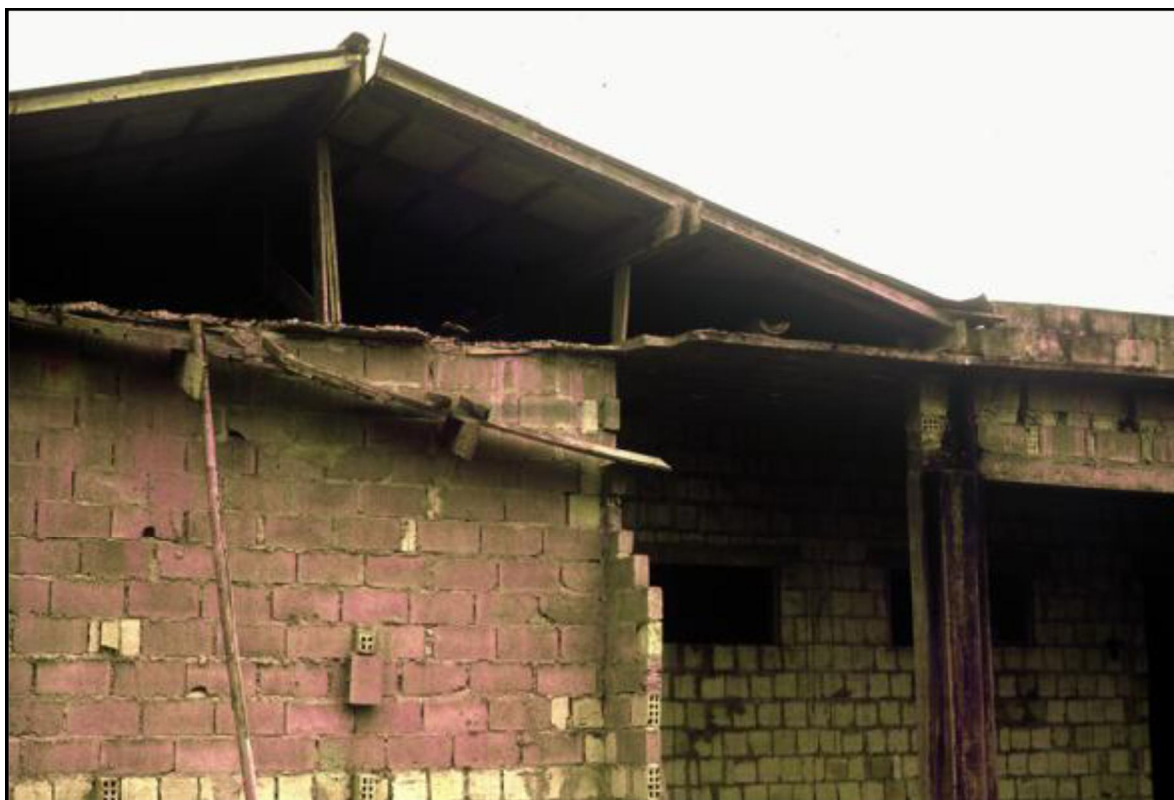
Figura 5 – Construção em estado de abandono, de uma das enfermarias do piso superior.
